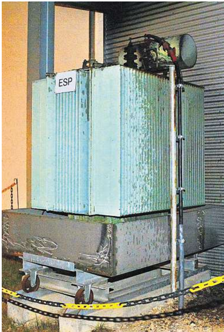
Der Brand dieses Transformators löste den Stromausfall aus. Foto: szd
